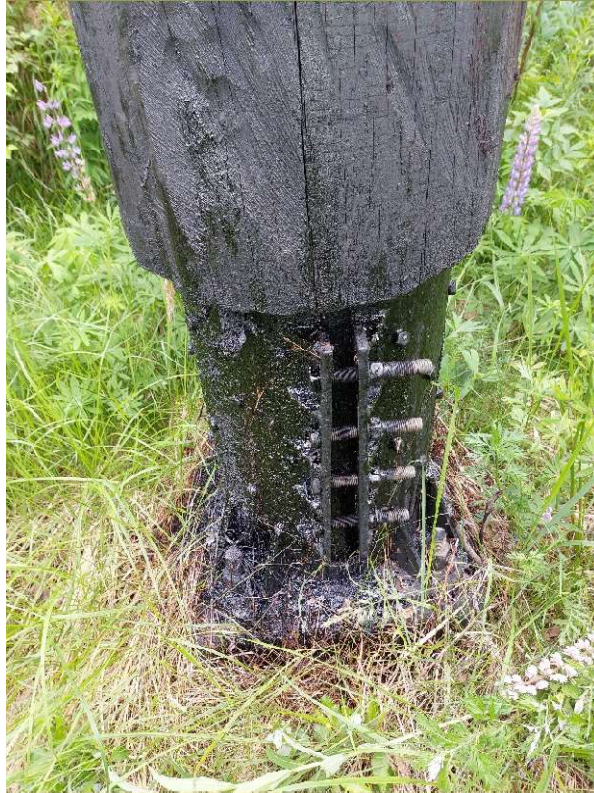
Kuva 3. Pylväässä nro 21 havaittiin eniten valumaa maaperään noin 20 cm etäisyydelle pylväästä.
