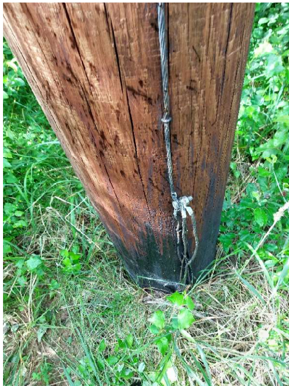
Kuva 6. Pylvään nro 53 tyvellä ei havaittu enää uutta valumaa.
