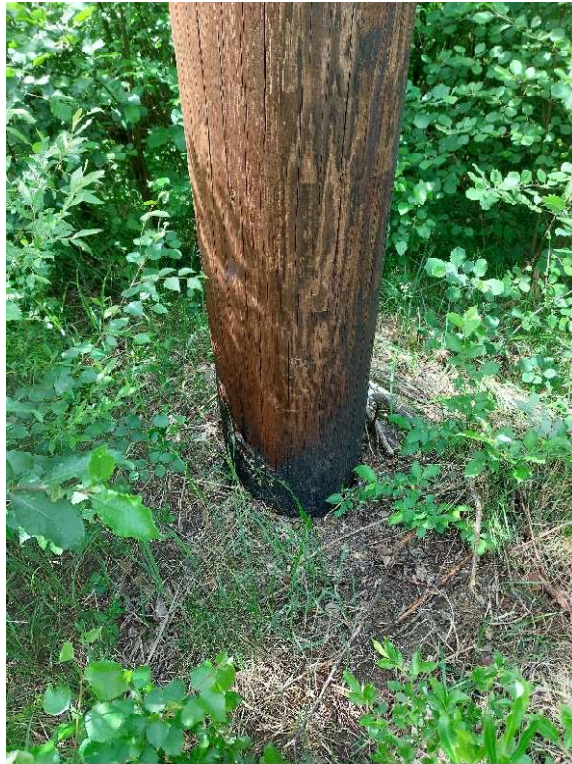
Kuva 1. Pylvään nro 2 tyvellä ei havaittu enää uutta valumaa.
