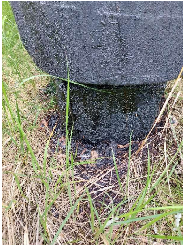
Kuva 2. Pylvään nro 6 tyvellä havaittiin valumaa maaperään noin 30 cm etäisyydelle pylväästä.
