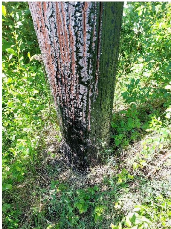
Kuva 8. Pylväässä nro 58 havaittiin runsasta valumaa rungolla ja maassa 13 cm etäisyydellä pylväästä.
