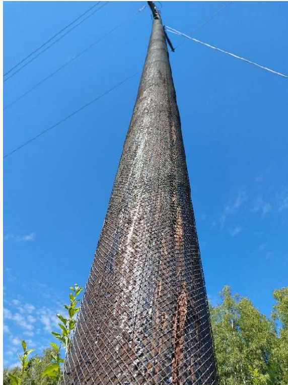
Kuva 7. Pylväässä nro 57 havaittiin melko runsasta valumaa rungolla ja maassa 14 cm etäisyydellä pylväästä.
