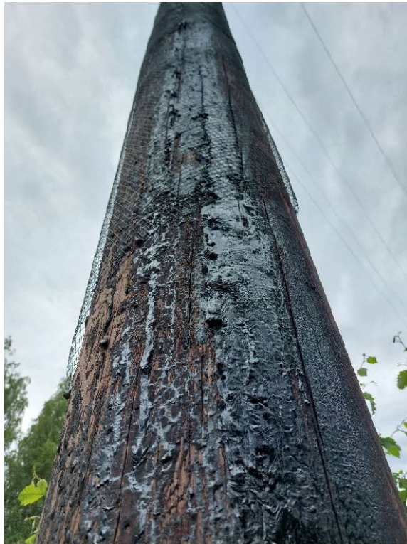
Kuva 5. Pylväässä nro 36 havaittiin runsasta valumaa rungolla ja maassa 7 cm etäisyydellä pylväästä.
