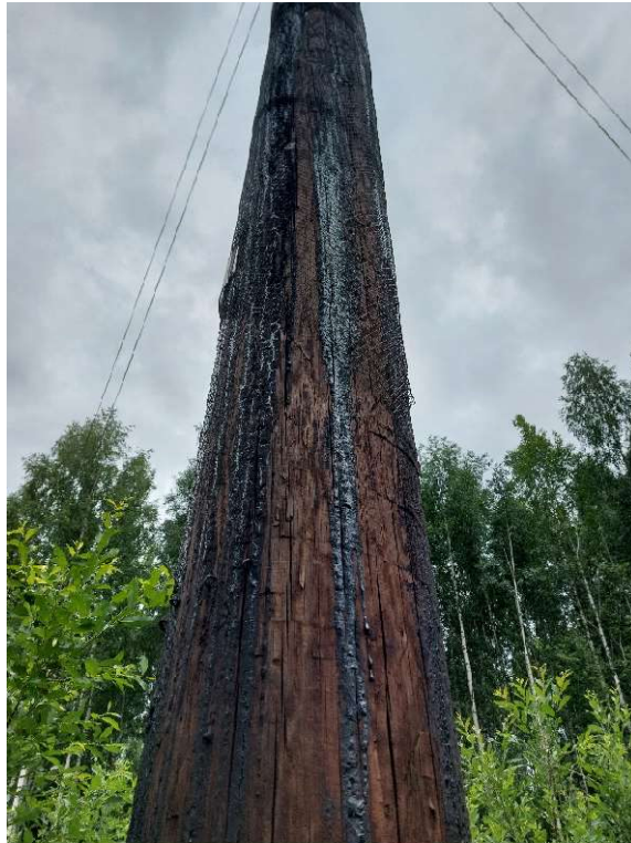
Kuva 4. Pylväässä nro 28 havaittiin uutta valumaa rungolla ja maassa 16 cm eäisyydellä pylväästä.
